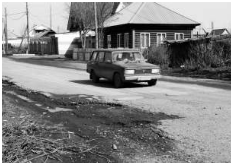
Разрушенные участки асфальта на улице Клубной водители вынуждены объезжать по встречной полосе.
