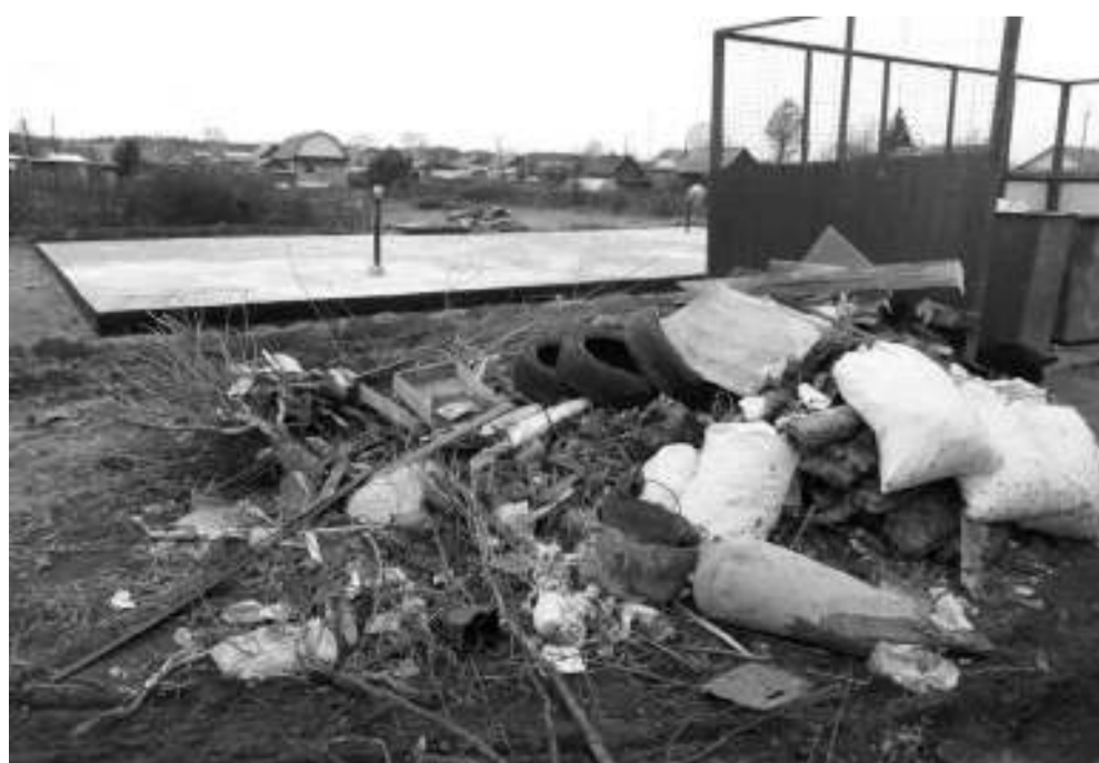
Свалка на улице АВПУ рядом со строящейся газовой котельной.
